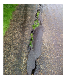
Scheurvorming asfalt Don Bosco (7)
