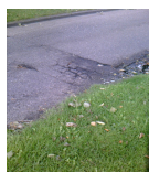
Oneffenheden, reparatievak Makassarbuurt (10)
